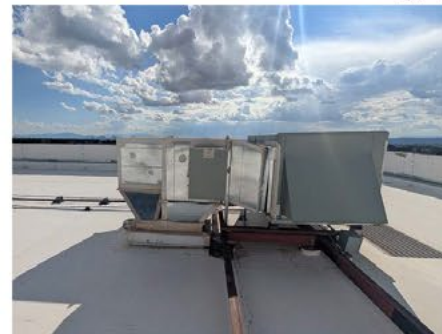
3) Roof Top Unit
